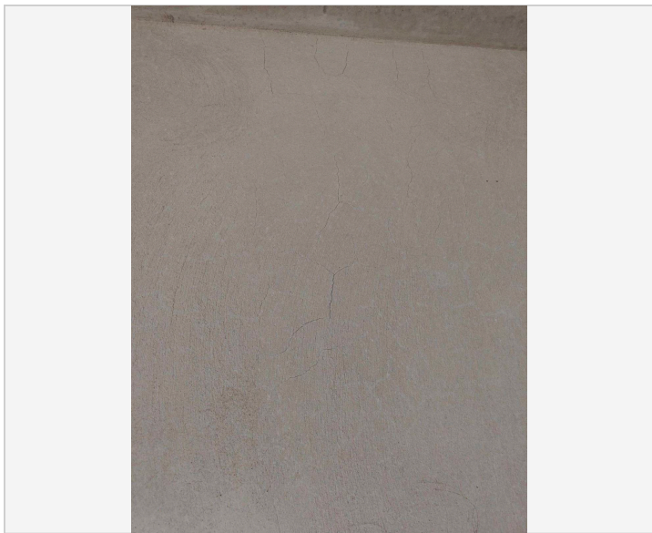
Г.тверь жк Онегин · Кв. Г.тверь жк Онегин — 14.10.2026 · Трещины на поверхности бетона (до 0,2 мм)
